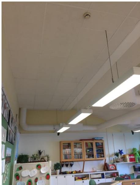
Ny installation av ventilation i klassrum skapar problem för städning.
