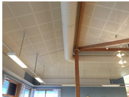
Synliga installationer i tak med hög takhöjd. Detta medför akustikproblem och svårigheter att städa.
