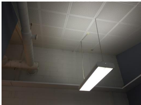
Synliga installationer i tak med hög takhöjd. Detta medför akustikproblem och svårigheter att städa.
