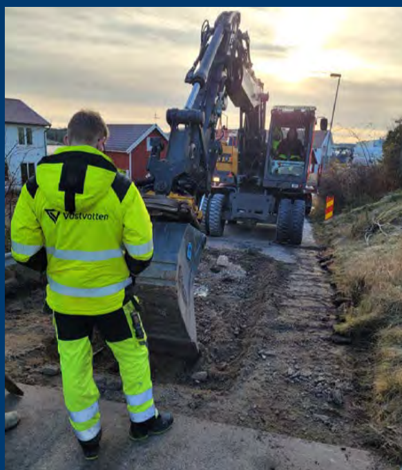
Åtgärder vattenläcka på Hovenäset. Fotograf: Victor Tånge
