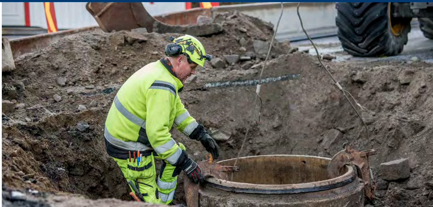
Lagning av huvudventil som förser Malmön med vatten /Sotenäs Vatten AB Fotograf: Viktoria Olsson
